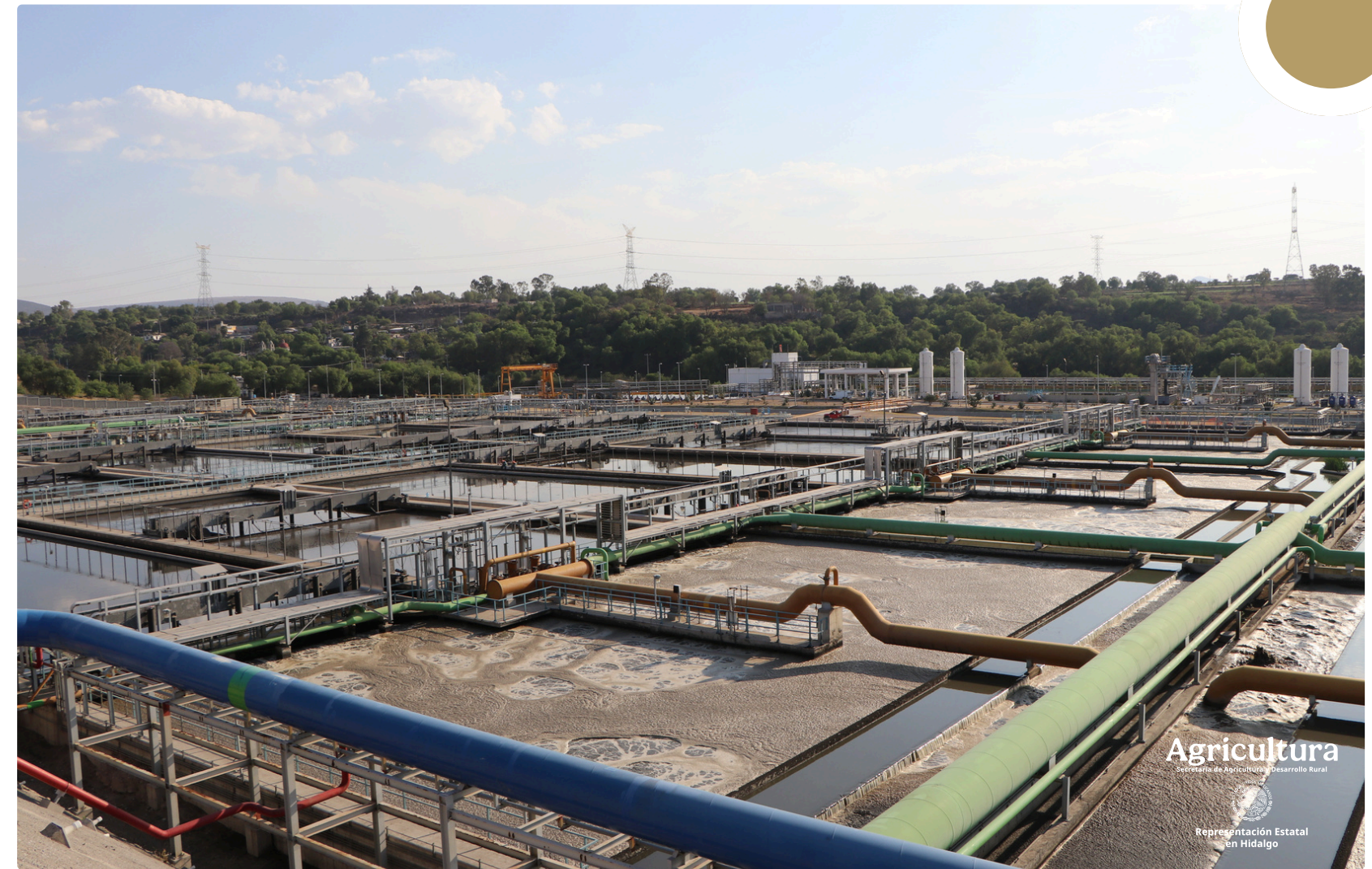
PTAR-Planta de Tratamiento de Aguas Residuales Atotonilco de Tula
